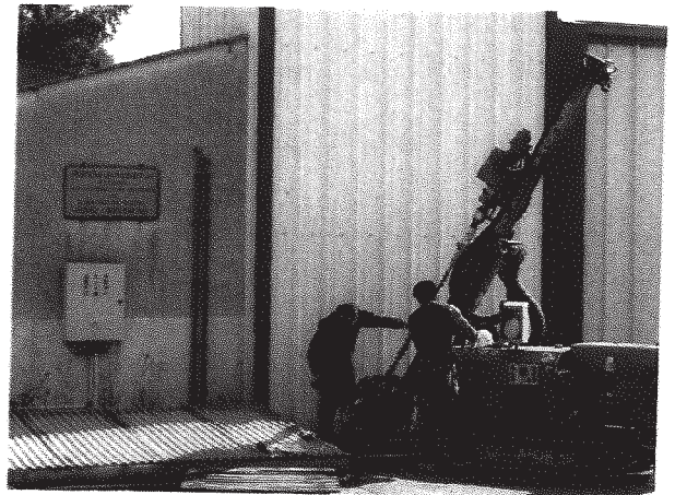
S2 : Station d'épuration
